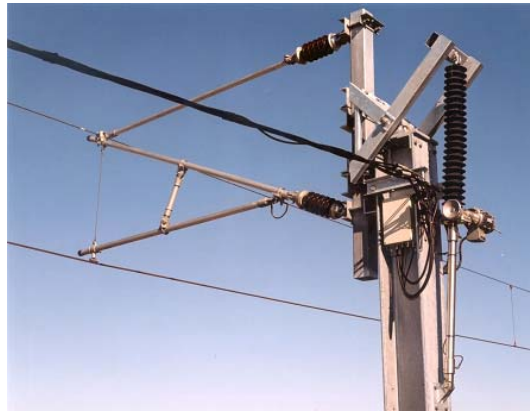
Figure 11.2: A Kippfahrleitung mast in down position
